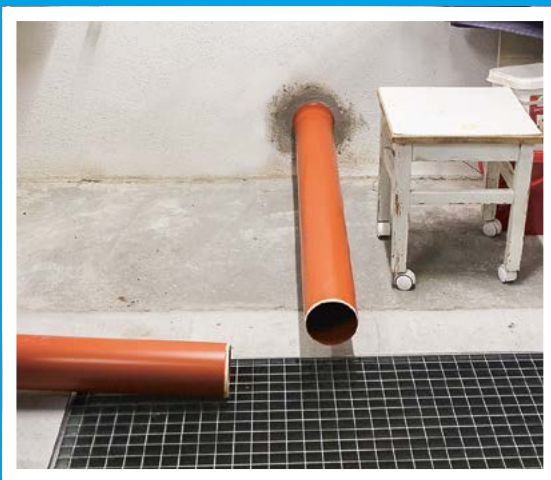
▲ Pumpensumpf mit Zulauf für Flutwasser
