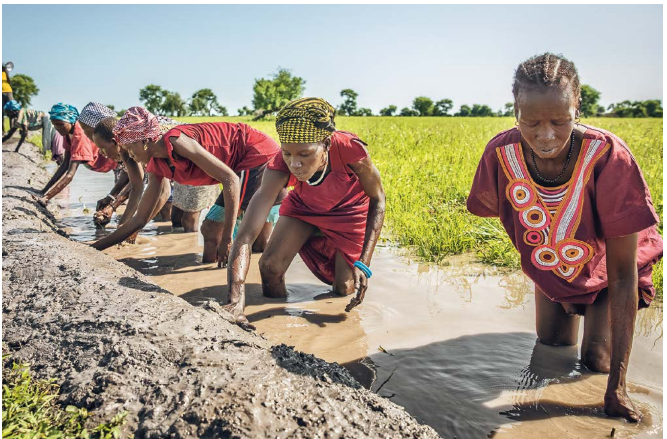
▲ Zum Schutz vor immer öfter wiederkehrenden Überschwemmungen im Südsudan errichten Arbeiterinnen in einem Projekt der Diakonie Katastrophenhilfe einen Damm aus Schlamm.
